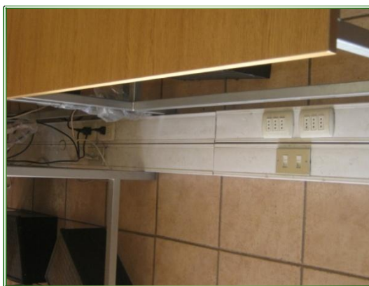
Instalación puntos de red
