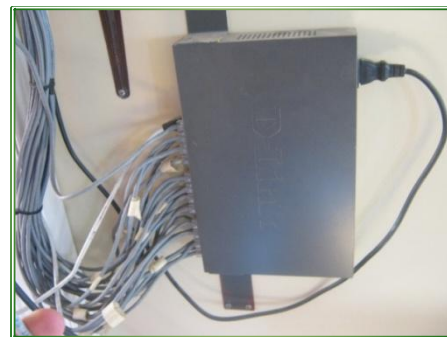
Instalación puntos de red
