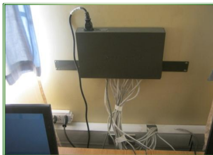
Instalación de Red de Sala Informática
