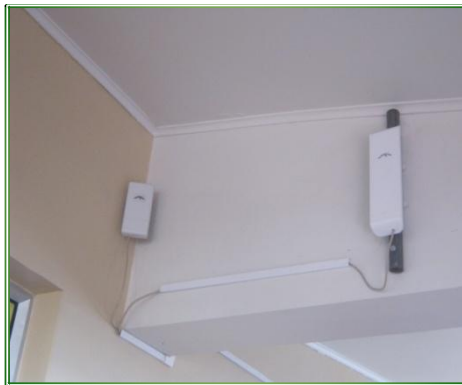
Instalación de Wifi
