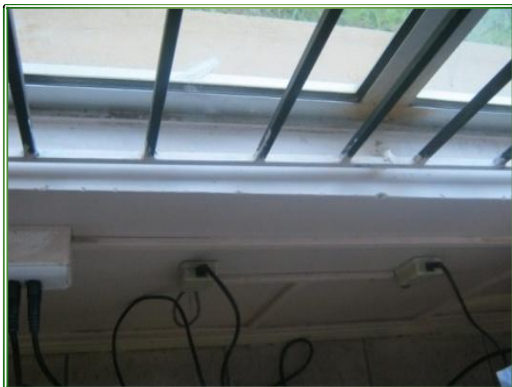
Instalación Puntos de Red
