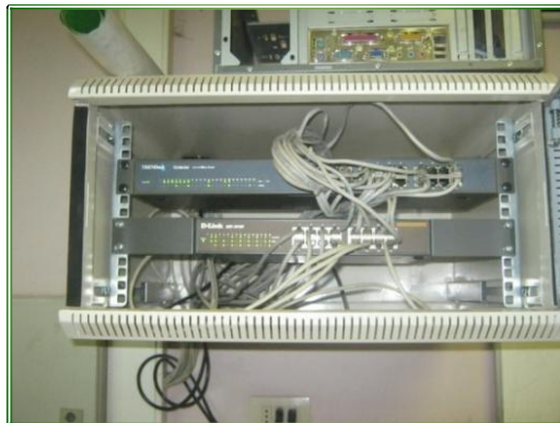
Instalación Puntos de Red
