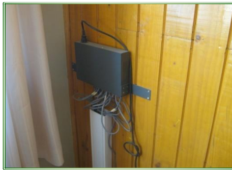
Instalación de Red
