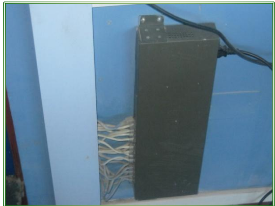
Instalación puntos de red
