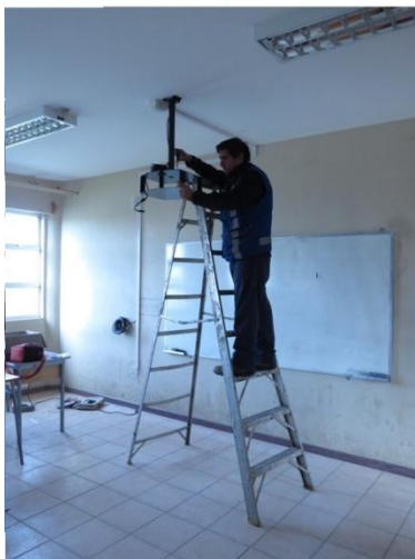
Instalación 32 Datas Liceo Municipal y Anexo Liceo Tecnico
